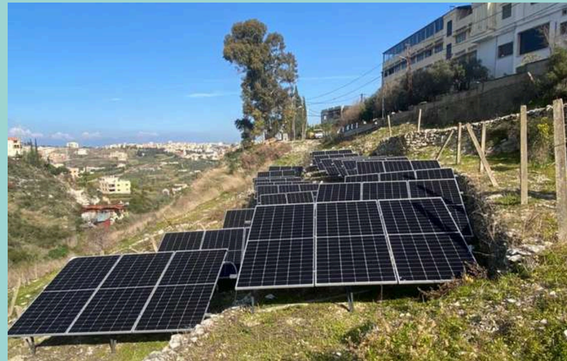
Panneaux solaires, Ain el Delb, janvier 2025 45 écoles équipées en 2024
